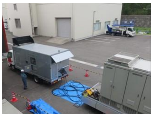
電源車操作訓練（高圧負荷車接続）
