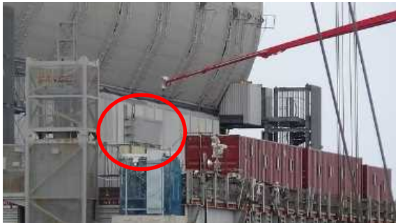
3号機注水受け口
