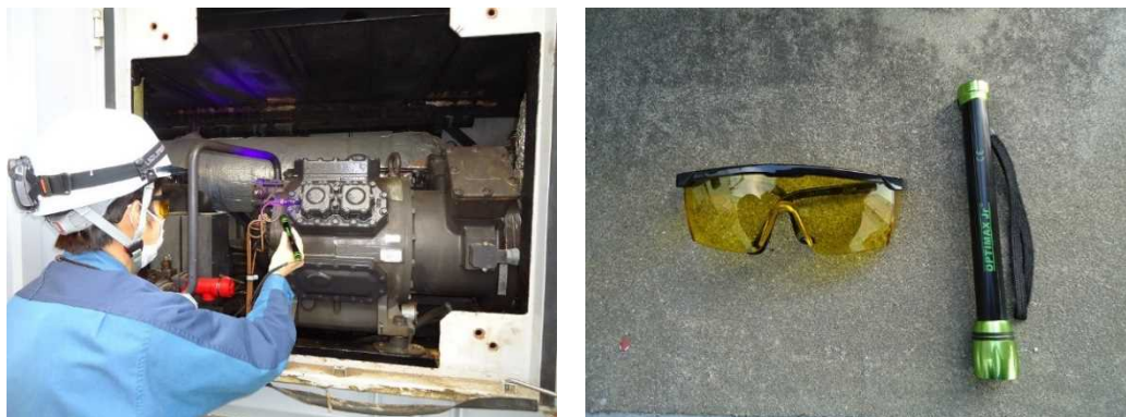
空調用冷凍機への蛍光剤注入による冷媒漏えいの検知
