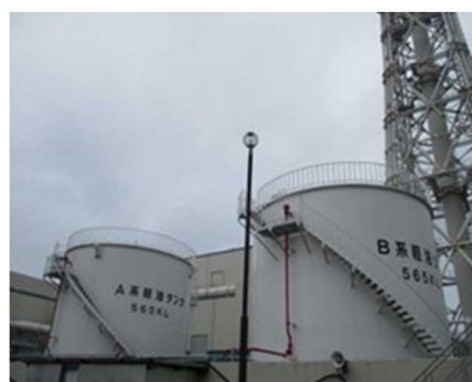
6号機軽油タンク
