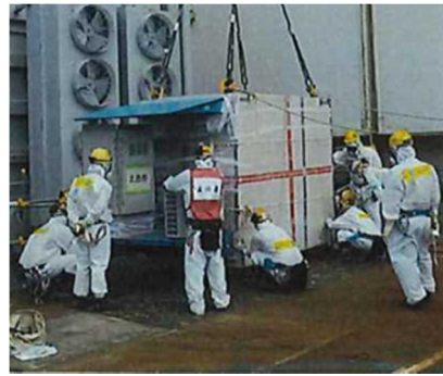
測定装置設置状況
