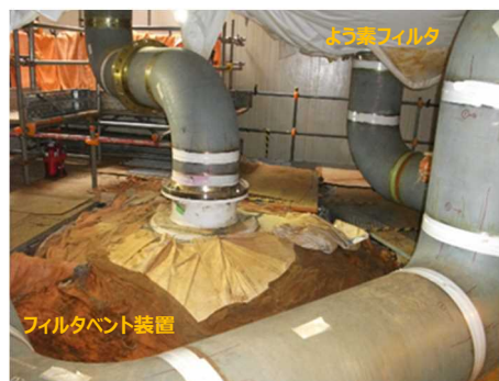
よう素フィルタ廻りの配管（6号機）
