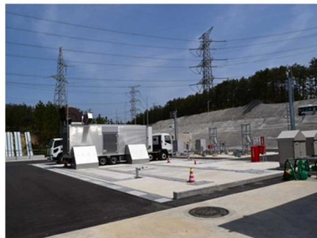
追設した空冷式ガスタービン発電機車
