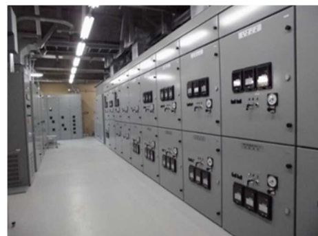
荒浜側緊急用配電盤
