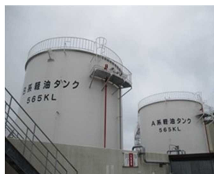
7号機軽油タンク
